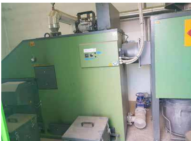
Sječka se koristi kao bioenergent za opskrbu toplinskom energijom
